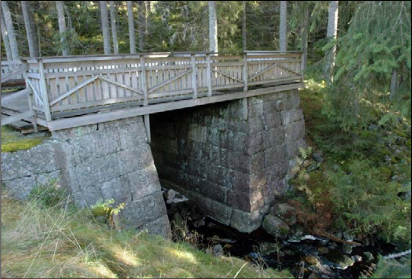
Her stoppet ruveselskapets jernbaneplaner, ved brua over Røisitjernsbekken ved Røisvangen.
